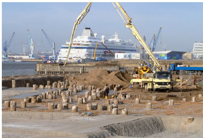
Bild 13 Kappen der Pfähle und Herstellen der Sauberkeitsschicht Capping of piles and production of blinding layer
